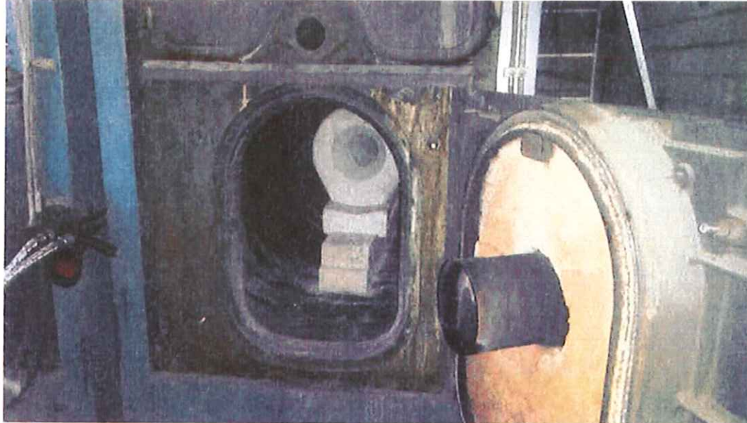
Bild 1: Flammrohr der Kesselanlage mit eingebauter Speicherkeramik
